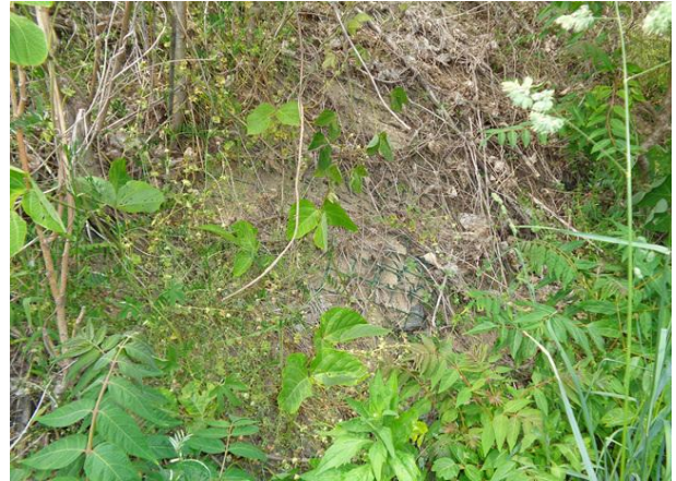
위 치 STA.0+720 3단 내 용 녹생토 식생불량, 능형망 노출
