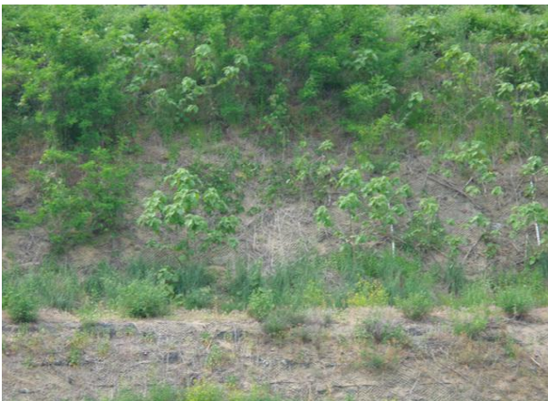
위 치 STA.0+850 1~2단 내 용 녹생토 식생불량, 능형망 노출
