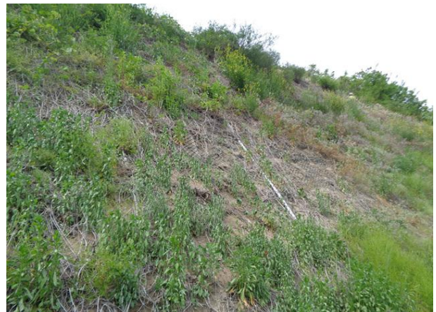
위 치 STA.0+650 2단 내 용 녹생토 식생불량, 배수관 노출
