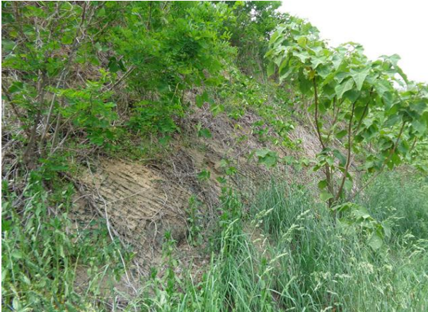
위 치 STA.0+720 3단 내 용 녹생토 식생불량, 능형망 노출
